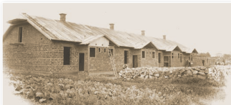
Stavba obecních nouzových domků v Hranicích v roce 1925. Foto: 5x archiv hranického muzea
